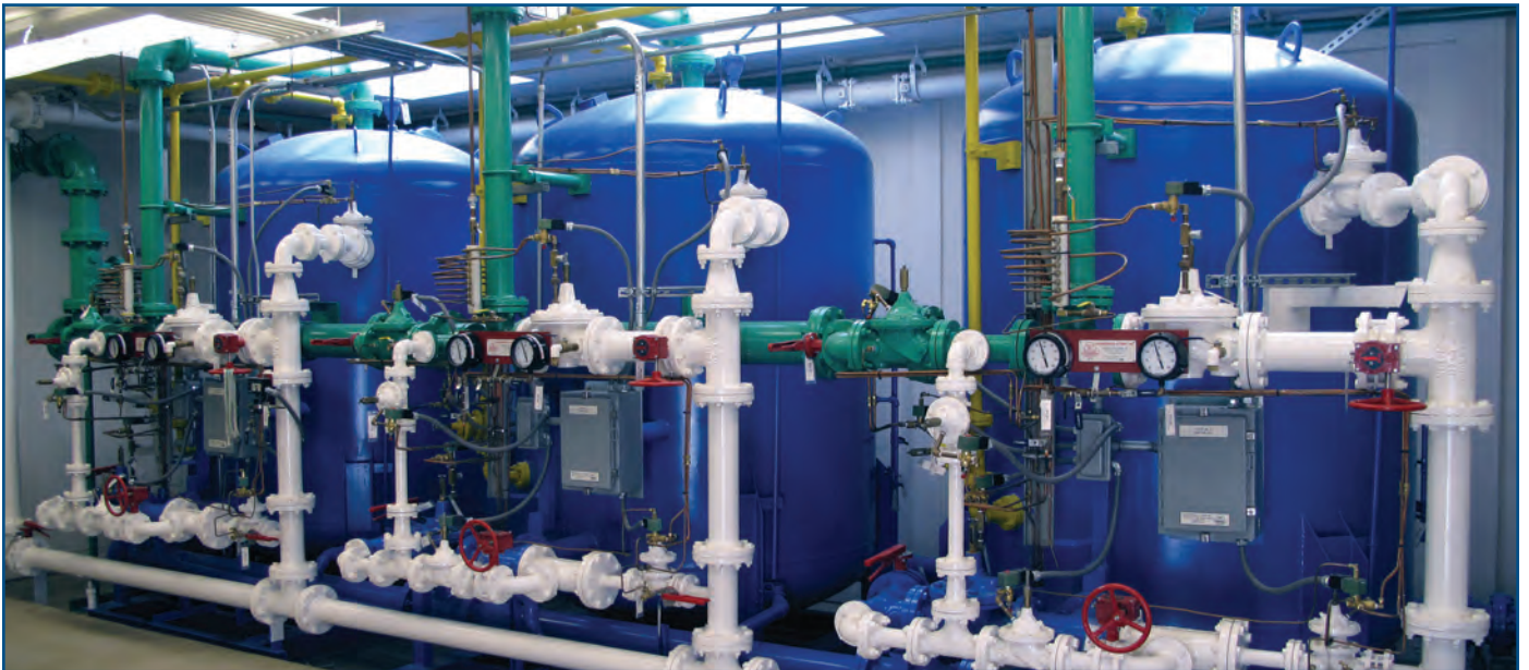
Este es un ejemplo de la instalación de un filtro municipal de 1.5 MGD con limpieza de aire/agua, realizado por Hungerford & Terry.
