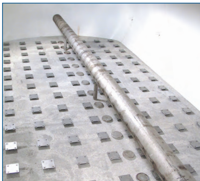
Un filtro horizontal con el desagüe inferior instalado (vista interior).
